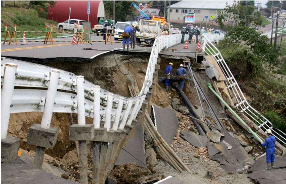
Figura 1. Panorámica de una vía en Japón afectada por el terremoto de 2004.
