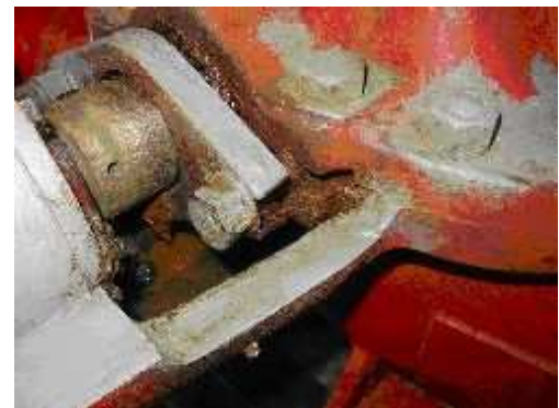
Efectos de la corrosión galvánica en la camisa de bronce de un eje y en el prensaestopa de una bomba.
